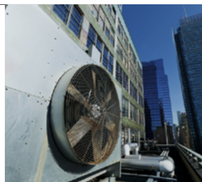
Sistema de aire acondicionado
